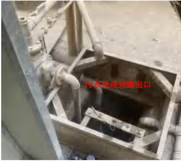
现有生活污水处理设施
